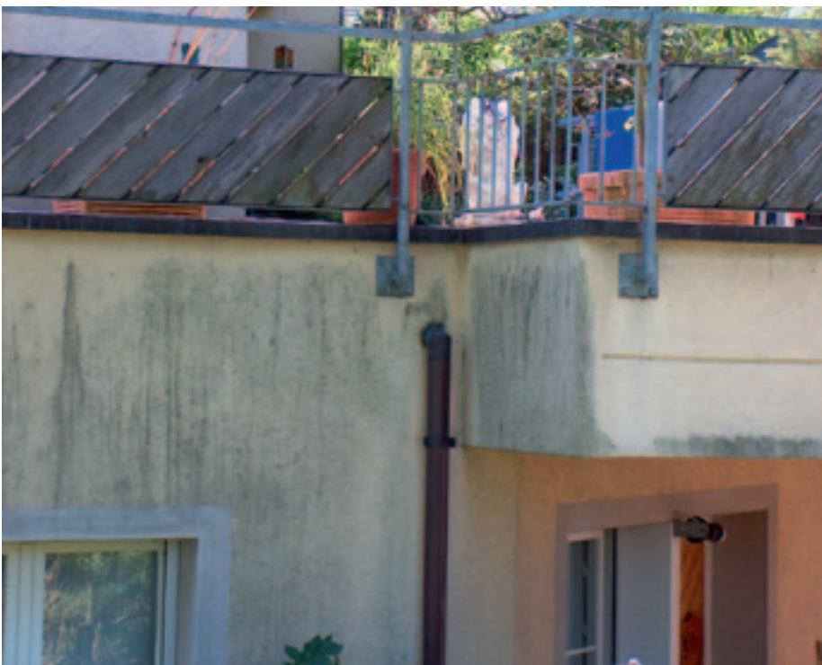
Algenbefall an der Aussenfassade ist nur schwer vorhersehbar. (Bild: Walter Schläpfer)
