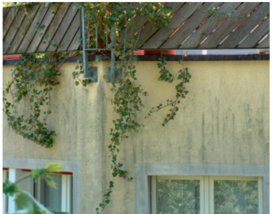
Le développement d'algues sur les façades extérieures n'est que difficilement prévisible.
