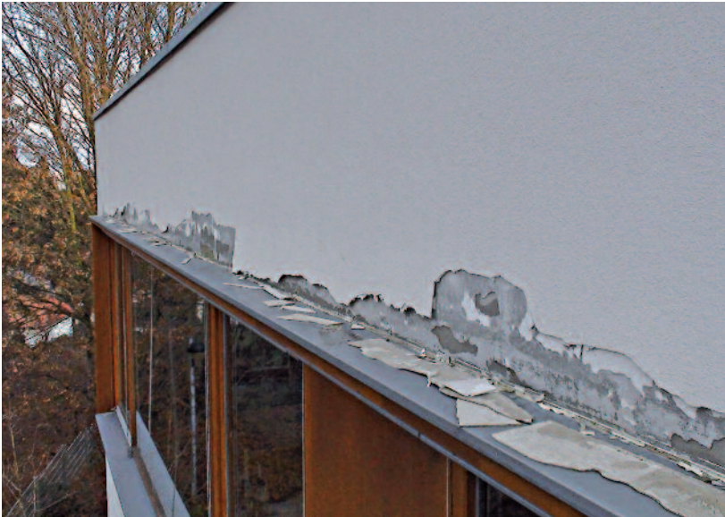
4 Vorstehendes Fenster mit großflächig abplatzendem Putz.
