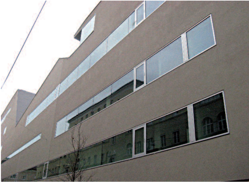
1 Anfällig für Schäden: Fassade mit putzbündigen Fenstern.
