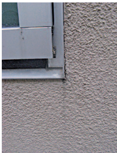
3 An diesem putzbündigen Fensteranschluss reißt der Putz an dem Metallrahmen. Außerdem entstehen Ablaufspuren.
